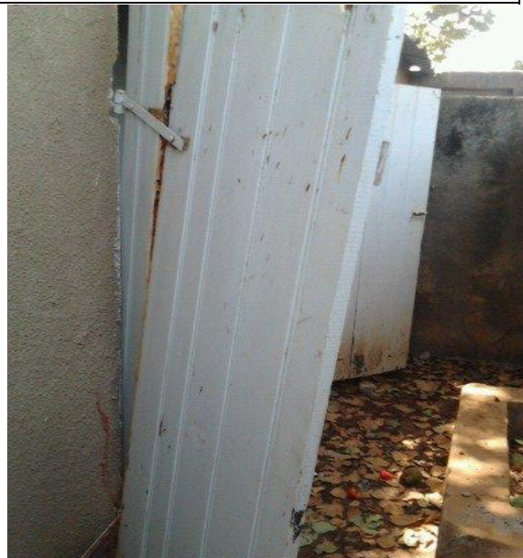
Latrine Publique- Site de démonstration -école (Vue de l'intérieur (PDAZ)
