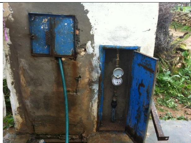
Photo 3 : Compteur d'eau d'une borne fontaine
