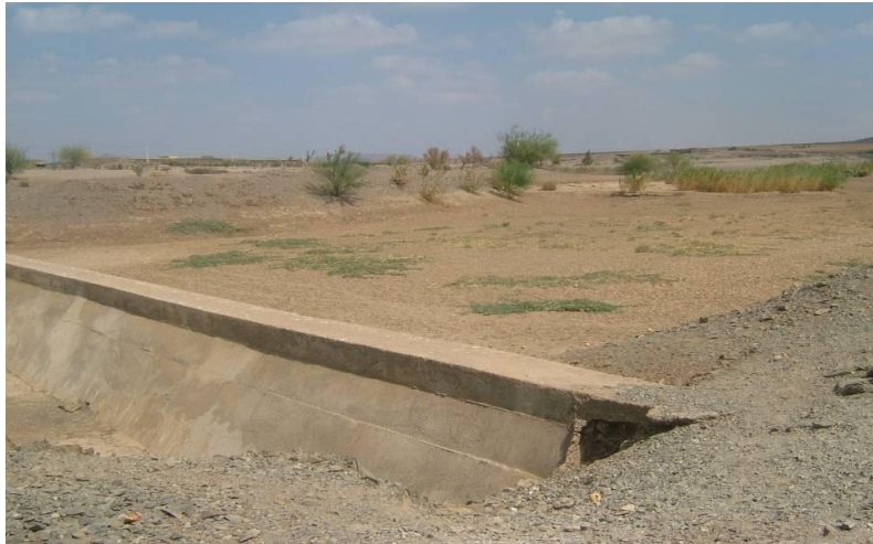
Seuil en béton dans la région de Marrakech
